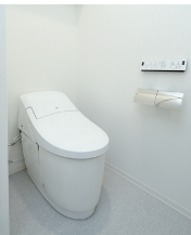
タンクレストイレ
